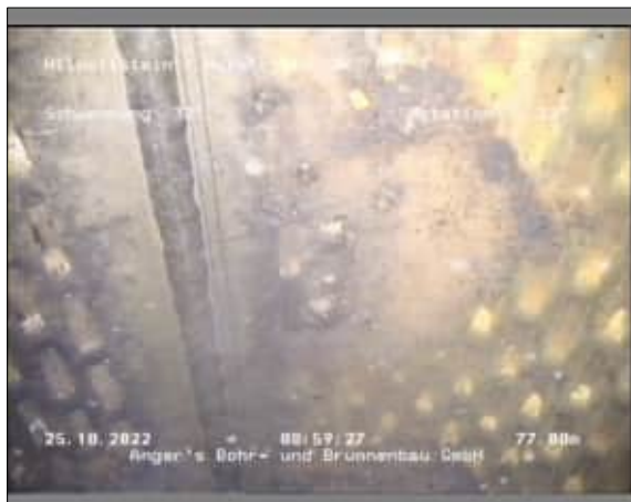
Foto: 1_1_33_A.JPG 77,00m, Ablagerungen biologisch
