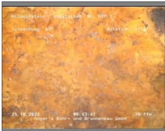
Foto: 1_1_19_A.JPG 38,71m, Filterschlitz geschlossen
