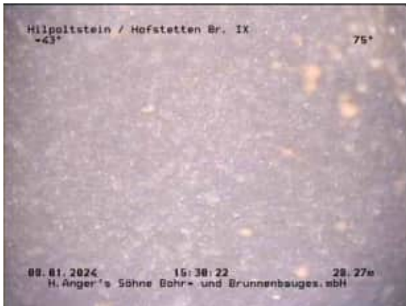
Distanz: 28.27m Foto Nr.: 13 Ablagerungen manganhaltig
