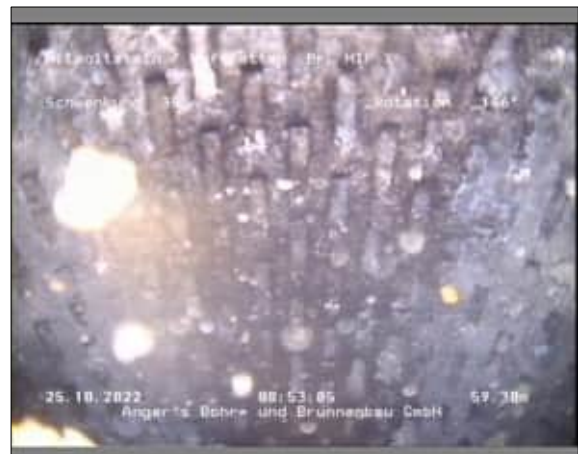
Foto: 1_1_26_A.JPG 59,30m, Ablagerungen manganhaltig
