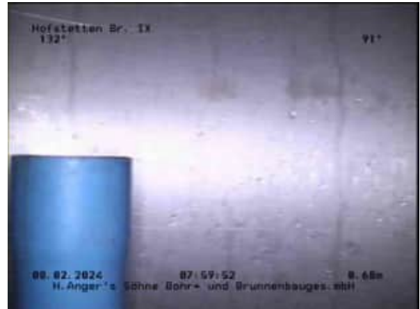
Distanz: 0.68m Foto Nr.: 2 OK Peilrohr 1
