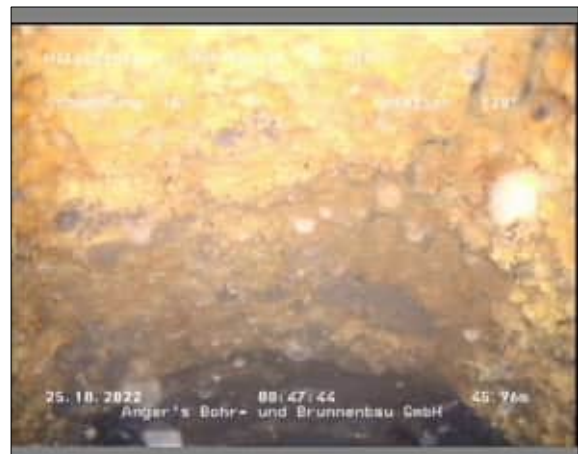
Foto: 1_1_22_A.JPG 45,96m, Filterschlitz geschlossen
