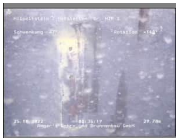
Foto: 1_1_12_A.JPG 29,70m, Scheuerstelle
