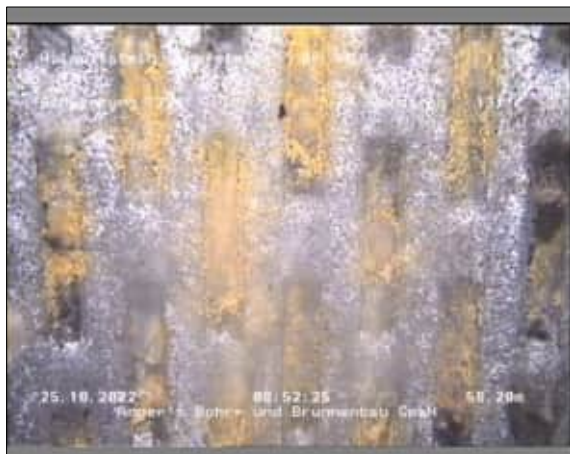
Foto: 1_1_25_A.JPG 58,20m, Filterschlitz geschlossen
