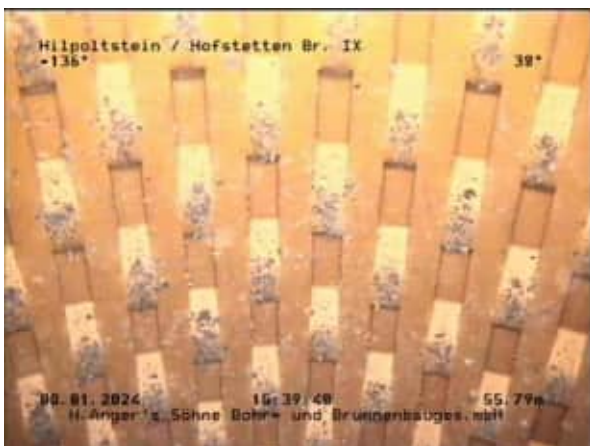
Distanz: 55.79m Foto Nr.: 19 Ablagerungen feinsandig
