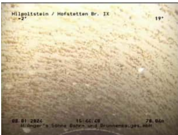
Distanz: 78.04m Foto Nr.: 23 Ablagerungen feinsandig
