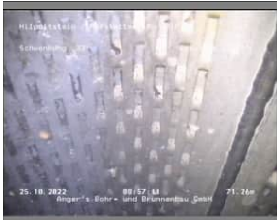
Foto: 1_1_31_A.JPG 71,26m, Filterschlitz teilweise geschlossen
