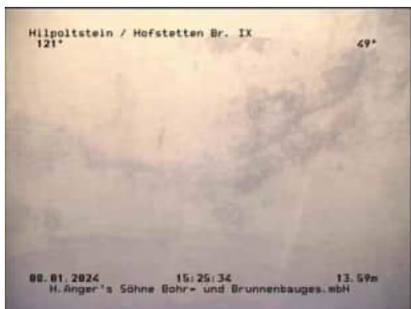
Distanz: 13.59m Foto Nr.: 9 Ablagerungen manganhaltig
