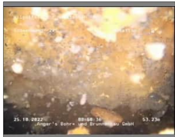
Foto: 1_1_24_A.JPG 53,23m, Filterschlitz geschlossen
