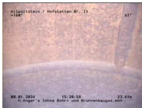
Distanz: 23.61m Foto Nr.: 12 Ablagerungen eisenhaltig
