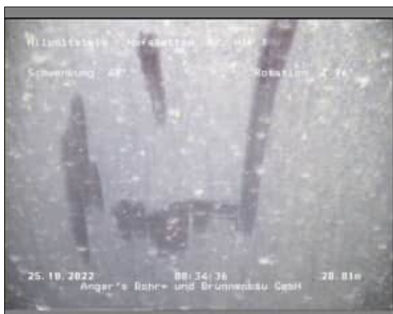
Foto: 1_1_11_A.JPG 28,81m, Scheuerstelle
