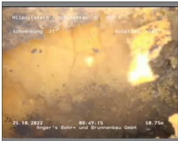
Foto: 1_1_23_A.JPG 50,75m, Ablagerungen biologisch
