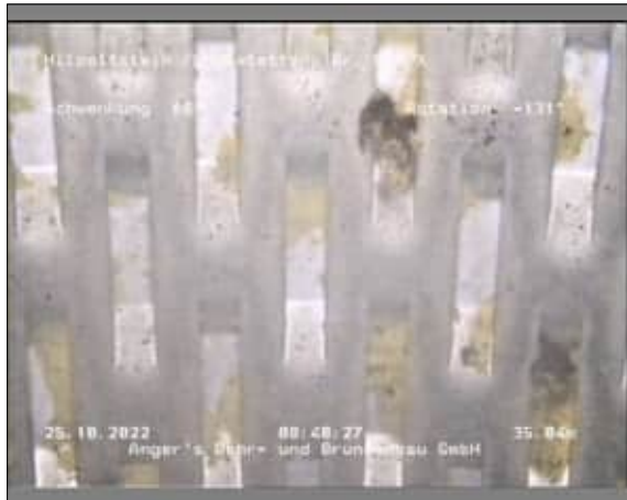
Foto: 1_1_15_B.JPG 35,04m, Filterschlitzte teilweise geschlossen
