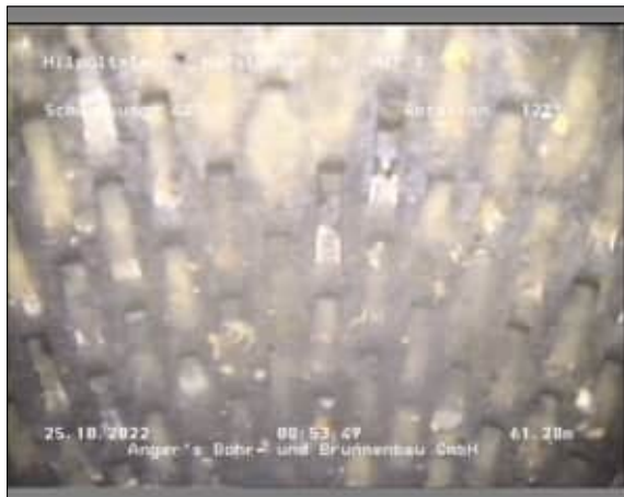
Foto: 1_1_27_A.JPG 61,28m, Ablagerungen biologisch
