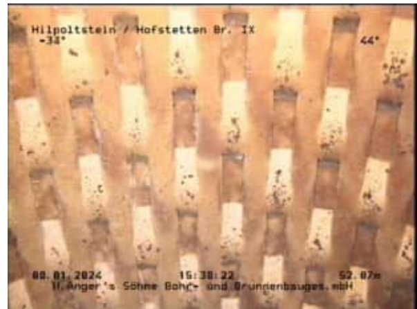
Distanz: 52.07m Foto Nr.: 18 Ablagerungen feinsandig
